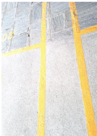
Figura 08 – Zoom da fissura
