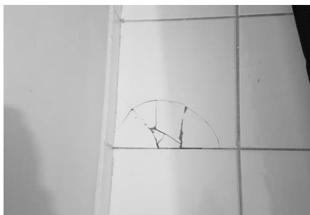
Figura 05 – Quebra do piso cerâmico devido ao descolamento do piso
