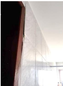
Figura 04 – Descolamento da cerâmica do banheiro
