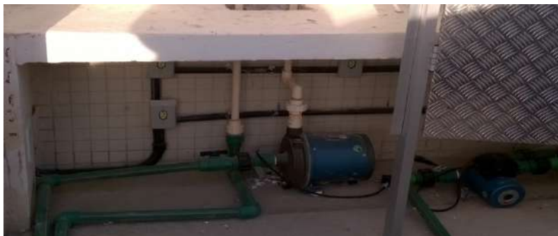
Figura 16- Pressurizador usado na obra
