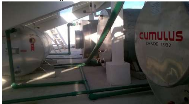
Figura 17- Conexão dos boilers
