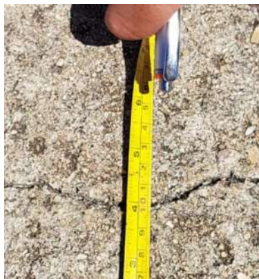
Figura 11 – Fissuras encontradas ao longo da barragem
