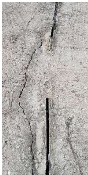
Figura 18 – Descontinuidade nas juntas de dilatação formando fissuras
