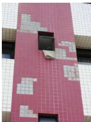
Figura 17 - Descolamento cerâmico da edificação 1
