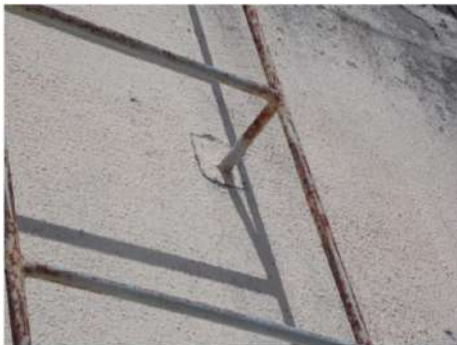
Figura 11 - Corrosão em todo corpo da escada
