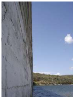
Figura 06 – Paramento de montante apresentando irregularidades causadas por falha de instalação das formas durante concretagem
