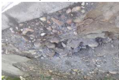
Figura 03- Desprendimento do concreto superficial a jusante.
