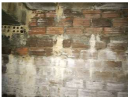
Figura 07 –Região interna da galeria com infiltrações.
