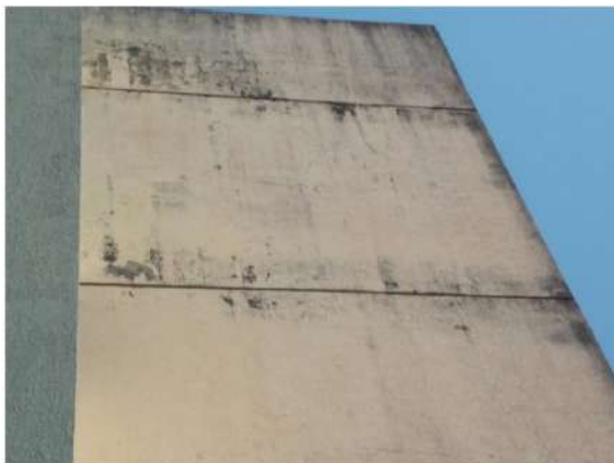
Figura 13 - Ocorrência de mofo na fachada do edifício.
