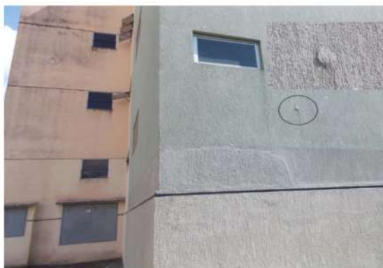
Figura 2 - Descolamento com pulverulência (fachada externa direita do térreo do bloco VL)
