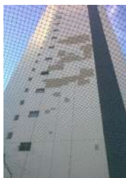
Figura 18 - Fachada da Edificação com descolamento cerâmico da edificação
