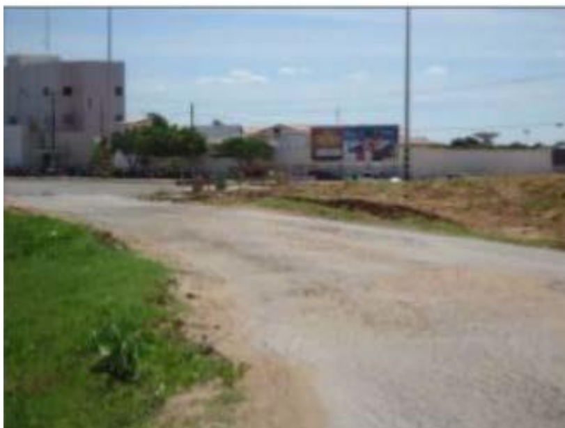
Figura 11 - Superfície irregular do asfalto
