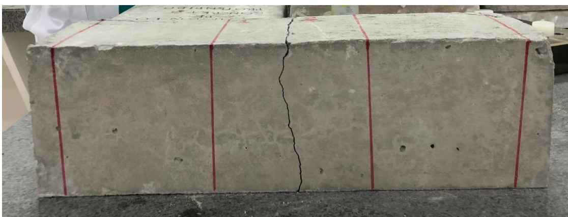
Figura 14: Viga trincada (Deformação elástica)
