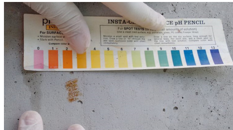
Figura 5 – Realização do ensaio de Ph em um dos pilares da piscina do complexo Noilde Ramalho.
