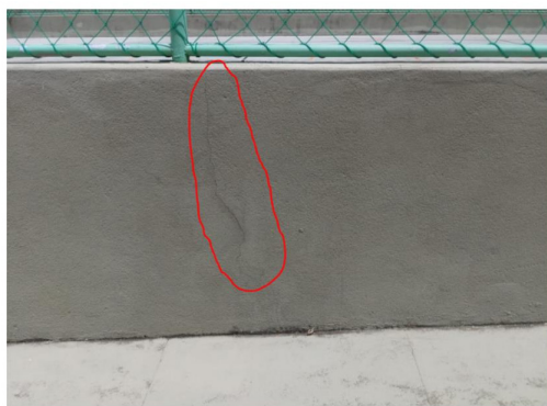
Figura 9 – Fissuras Quadra de Esportes.
