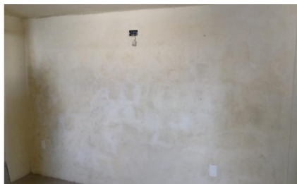
Figura 4 - Eflorescência parede interna (suporte do reservatório superior).
