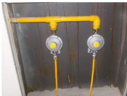
Figura 12 - Corrosão nas caixas de registro de gás do hall do edifício.
