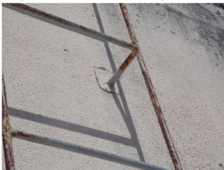
Figura 11 - Corrosão em todo corpo da escada
