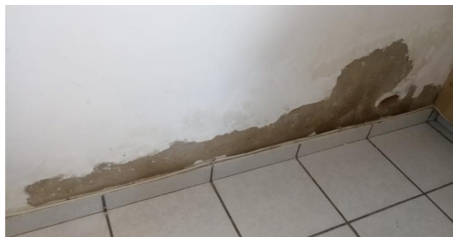
Figura 3 - Descolamento com pulverulência (parede da suíte do apartamento 301).
