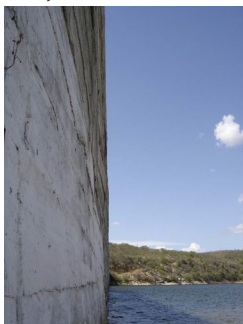
Figura 06 – Paramento de montante apresentando irregularidades causadas por falha de instalação das formas durante concretagem
