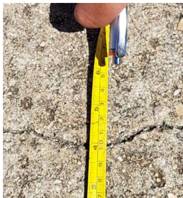
Figura 11 – Fissuras encontradas ao longo da barragem
