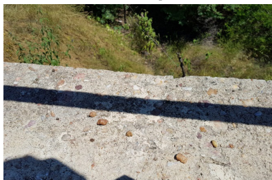
Figura 02- Desprendimento dos agregados do concreto superficial
