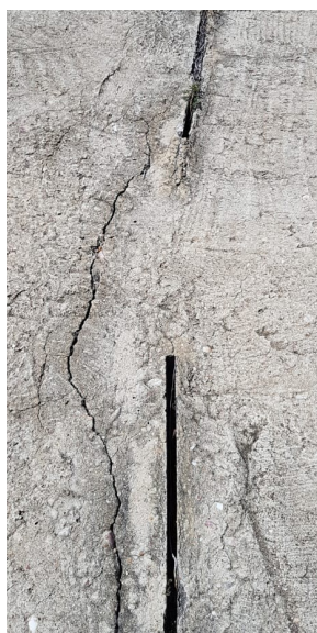
Figura 18 – Descontinuidade nas juntas de dilatação formando fissuras
