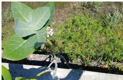
Figura 05 – Vegetação nascendo nas dobras do paramento a montante
