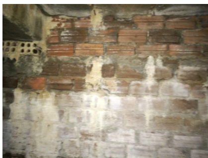
Figura 07 –Região interna da galeria com infiltrações.
