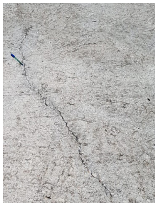
Figura 12 - Fissuras de um lado a outro da passagem da barragem
