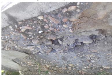
Figura 03- Desprendimento do concreto superficial a jusante.
