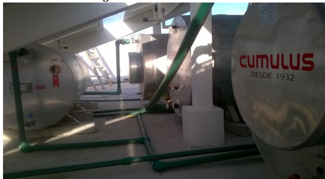
Figura 17- Conexão dos boilers
