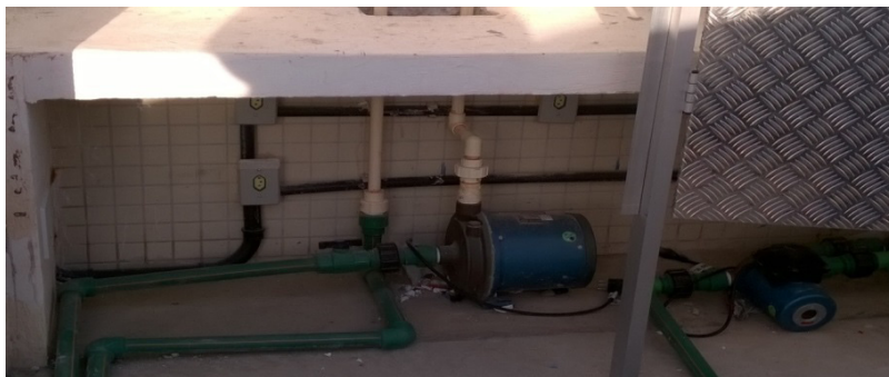
Figura 16- Pressurizador usado na obra
