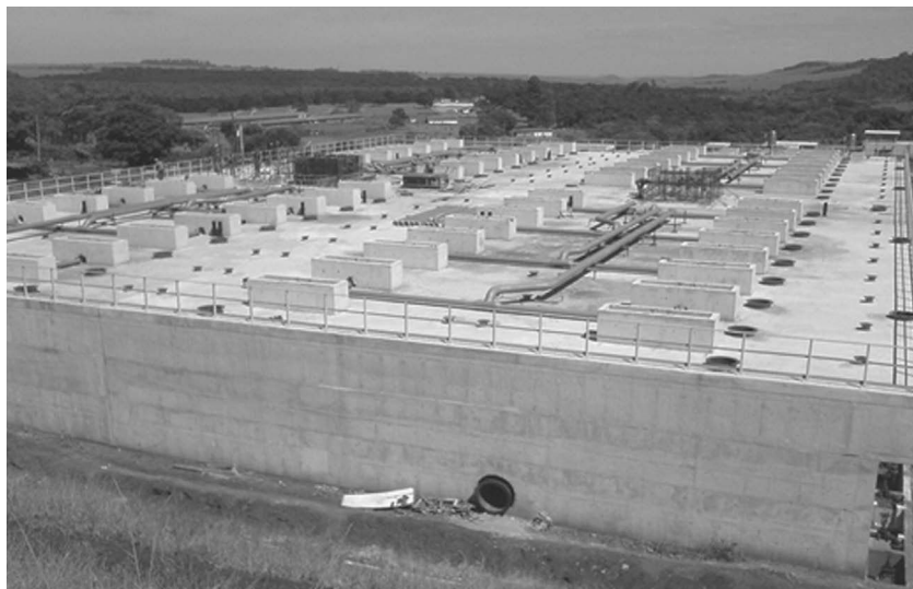
Fotografia 3: Sistema UASB – ETE São Carlos-SP.
