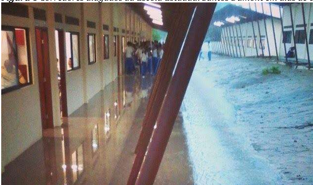
Figura 6 Corredores alagados da Escola Estadual Santos Dumont em dias de chuva.
